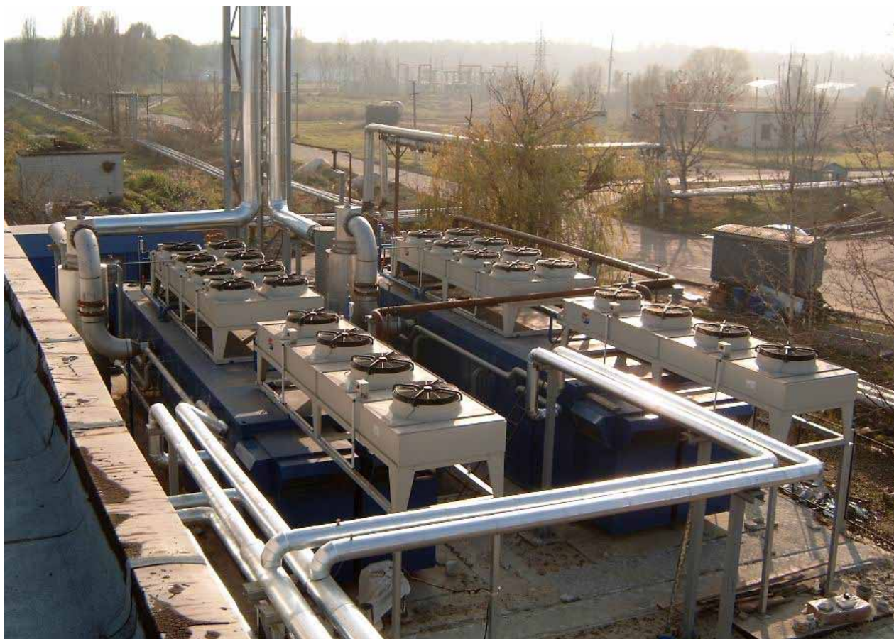
Фото 6. Вид сверху на когенерационную электростанцию птицефабрики «Орель-Лидер»
