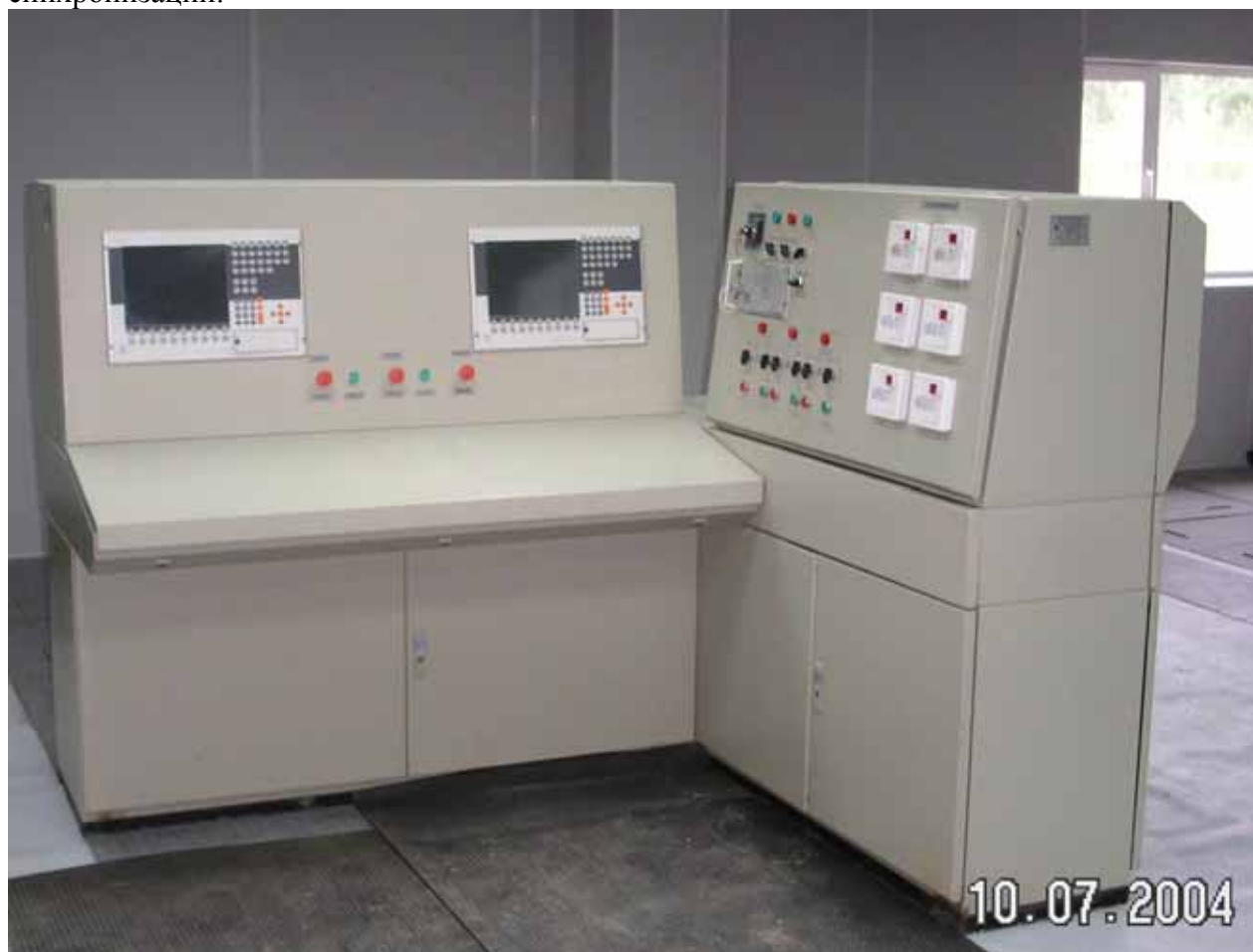
Фото 5. Пульт управления «ГТЭС-7,5 МВт»
